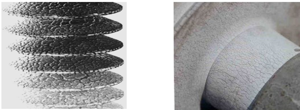
Рис. 3.24. Тріщини на поверхні ізолятора глибиною понад 0,1 мм
