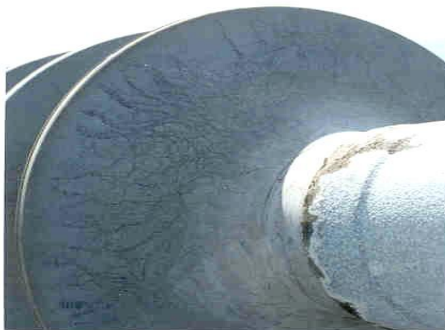
Рис. 3.20. Мікротріщини по поверхні ізолятора
