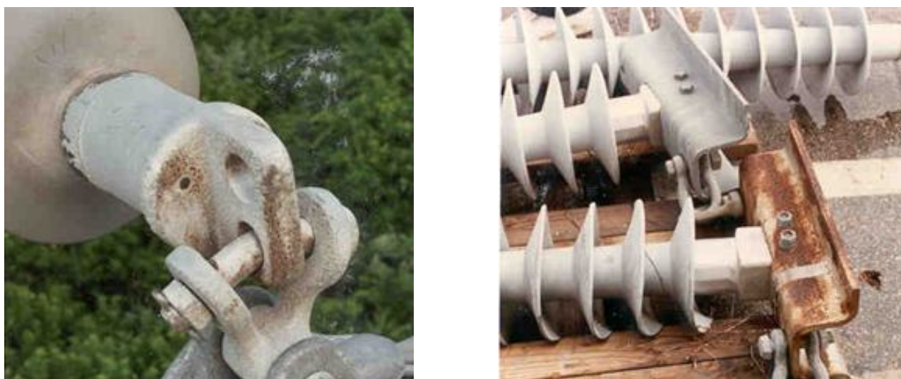
Рис. 3.19. Корозія на кінцях ізолятора
