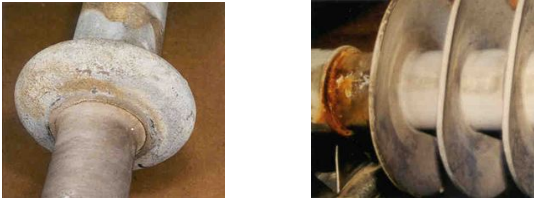
Рис. 3.23. Пошкодження корозією наконечників стрижня
