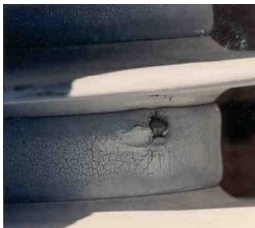
Рис. 3.22. Пошкодження з оголенням утримуючого склопластикового стрижня
