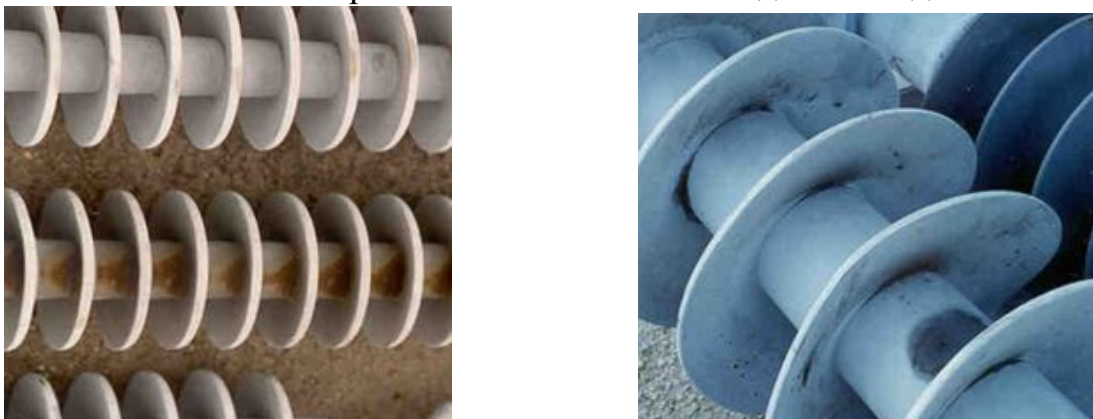
Рис. 3.13. Ізолятори з витіком наповнювача у місці з'єднання
