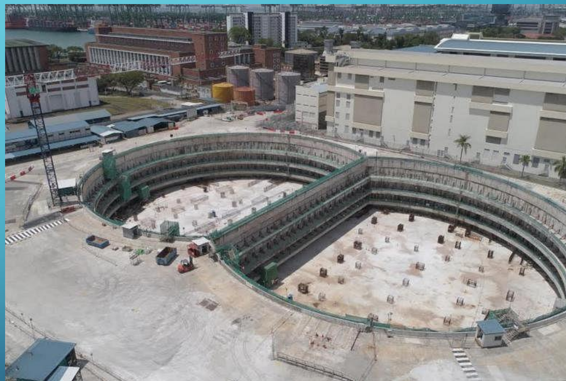
Підземна електростанція в Сінгапурі
